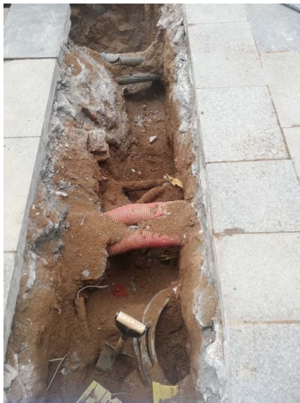
Fotografia 5. Detall rasa, presència de serveis antics
