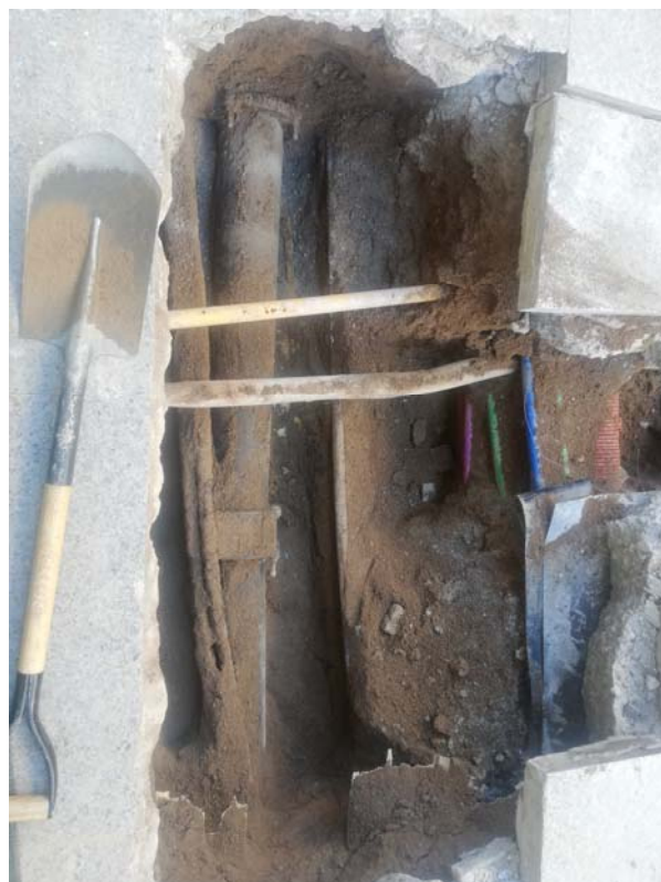
Fotografia 6. Detall rasa, presència de serveis antics
